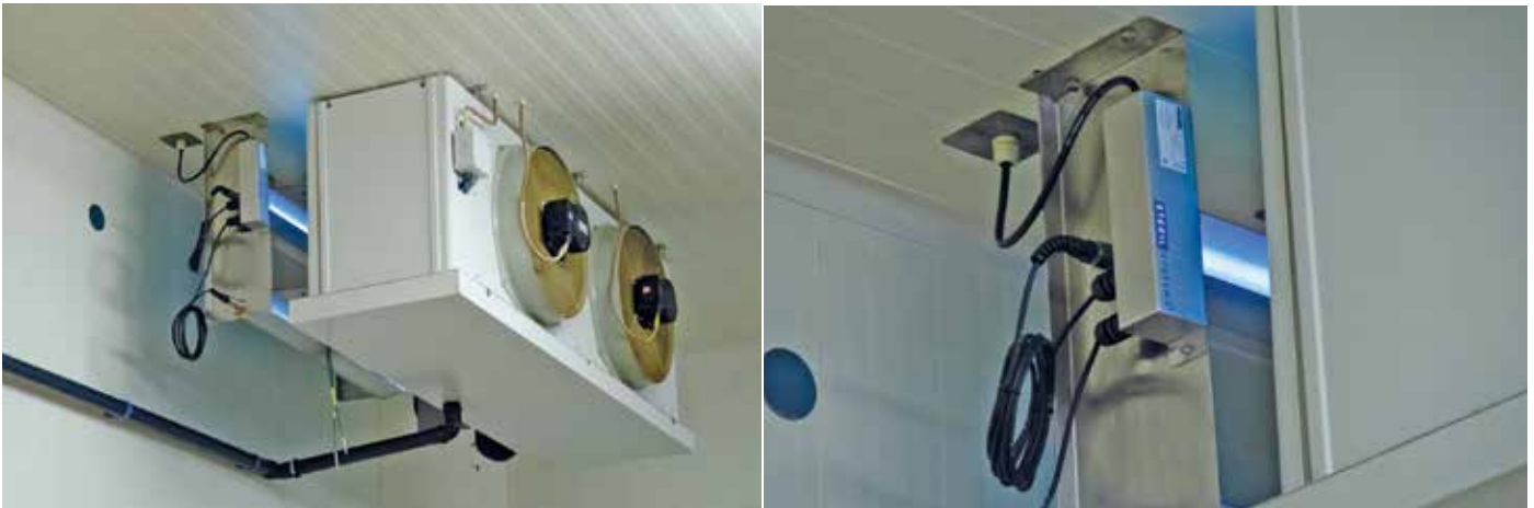
Seit 2016 verhindert eine Verdampferdesinfektionsanlage von Sterilsystems, dass sich auf den Lamellen der Klimatisierungsgeräte von Berger Schinken Biofilme bilden.
