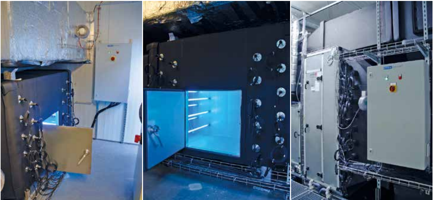
Vier Lüftungsanlagen von Berger Schinken sind mit TR-Systemen von Sterilsystems ausgestattet.
